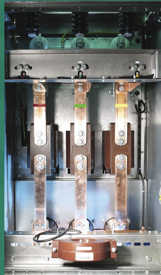
Рис. 3.10. Отсек линейных шин и кабельных присоединений
