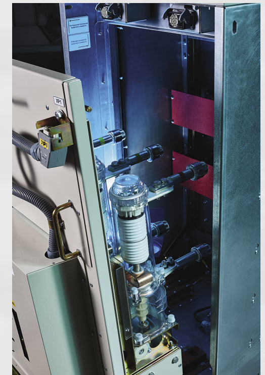
Рис. 3.3. Отсек выкатного элемента
