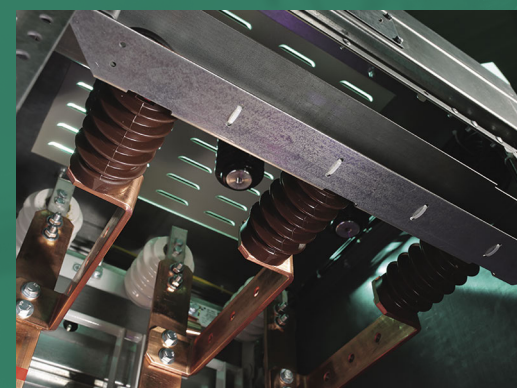
Рис. 3.11. Шины для подключения силовых кабелей
